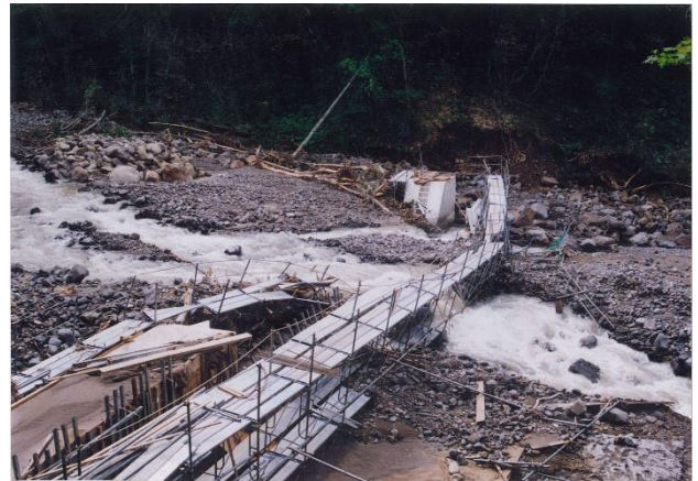
図-7 丸平の沢で施工中の No.6 床固工が破壊された状況。1999 年 7 月 29 日撮影。
