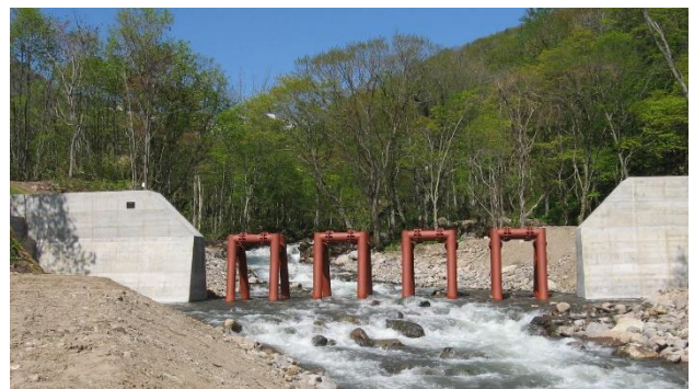
図-8 土石流対策を目的にしたスリットダム。
