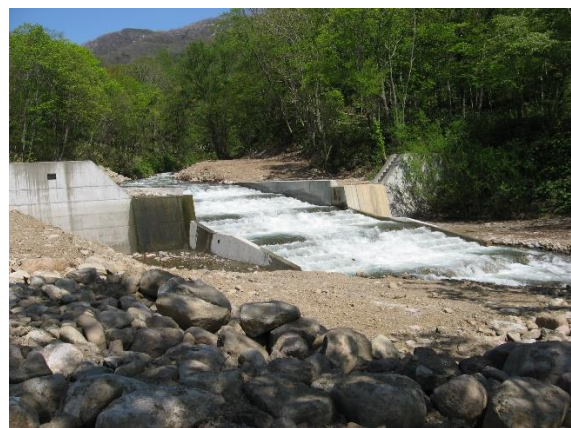
図-9 既設の床固工に設置された魚道。
