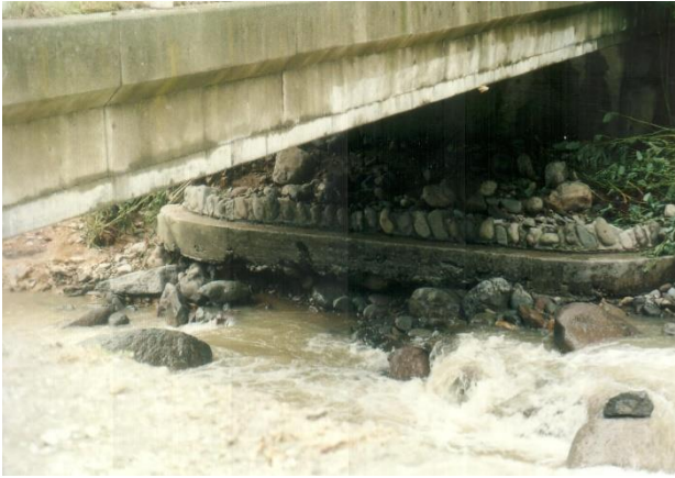
図-1 土石流により破壊された国道の橋台。通行ができなくなった。1999年7月撮影。
