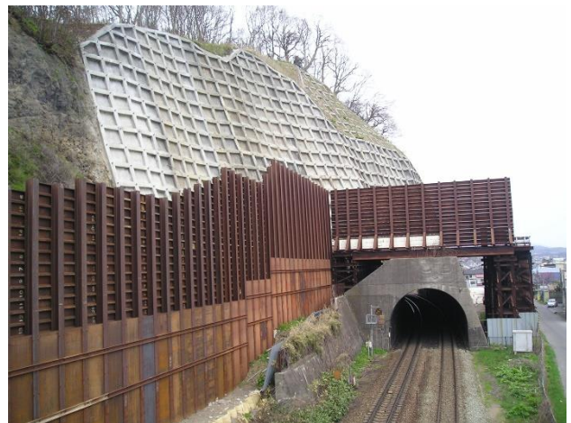
図-6 鉄道施設に影響を与えないようトンネル巻き出し部を覆う仮設工を採用した。仮設工の山側は、岩盤に推進工法で挿入した巨大なブラケットを土台にしており、巻き出し部へに対する近接施工範囲外となるよう配置している。
