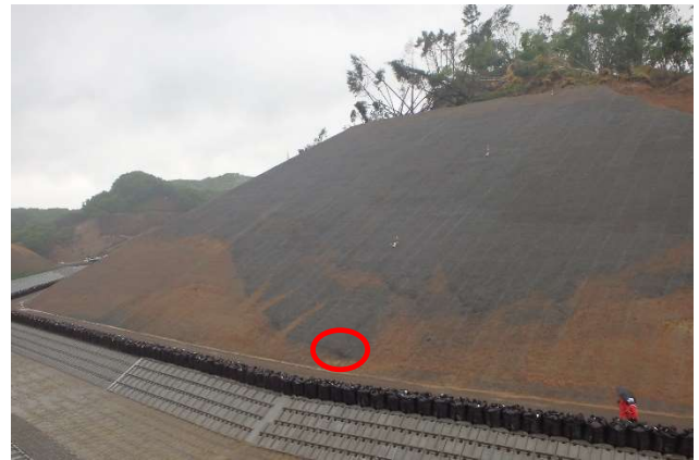
図-7 すべり層中に角礫が観察された日高幌内川地すべり移動体末端の仮排水路右岸法面露頭）．赤の円は図-6 の露頭位置．
